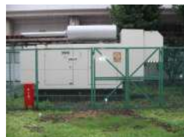
自家用発電設備
