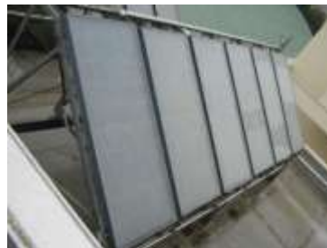
太陽熱集熱パネル
